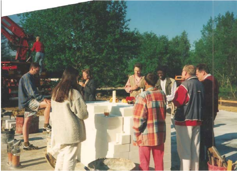
Grundsteinfeier in kleiner Runde [Bildmitte: Architektin Jo-Hanne Uphoff und Maurermeister Klaus Wieting].
